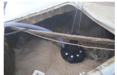
Noch ist der neue Tauchbelüfter an der Beckenoberfläche zu sehen: Gleich wird er auf den Boden abgesenkt - mehr als Stromkabel, Haltekette und Luftschlauch braucht er nicht. (Foto: Tsurumi) (Foto: Tsurumi) Download Foto
