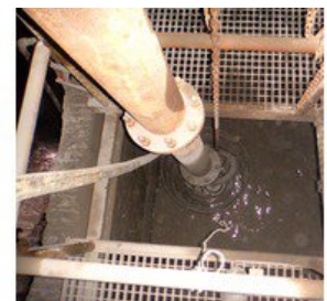
Pumpensumpf mit Steigleitung: Über 100 Pumpen von Tsurumi sind zur Wasserhaltung der Mine im Einsatz (Foto: Tsurumi) Download Foto
